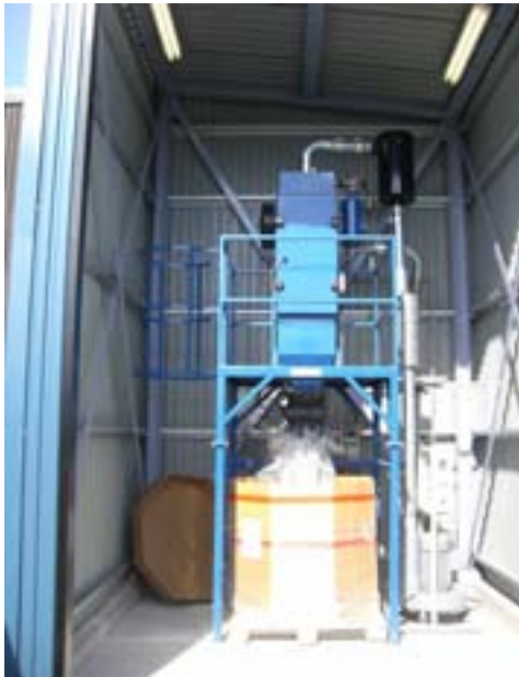
Bilden visar ett exempel på 13 kW pumpenhet samt patronfilter E4500 med rotorslussutmatning.
